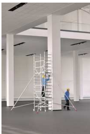
Auch Gerüste stellen sichere Arbeitsmittel für länger andauernde Tätigkeiten dar: Advanced SAFE-T
